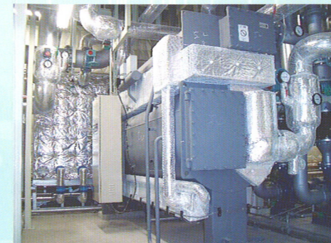
冷温水発生器
