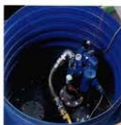
⑦ 油中マニホールド (タンクビット内部)
